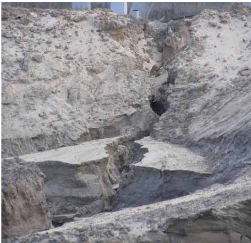
Рис. 1. Вид на эрозионное русло с конусом выноса на подошве откоса котлована (Ленинградская АЭС-2)
